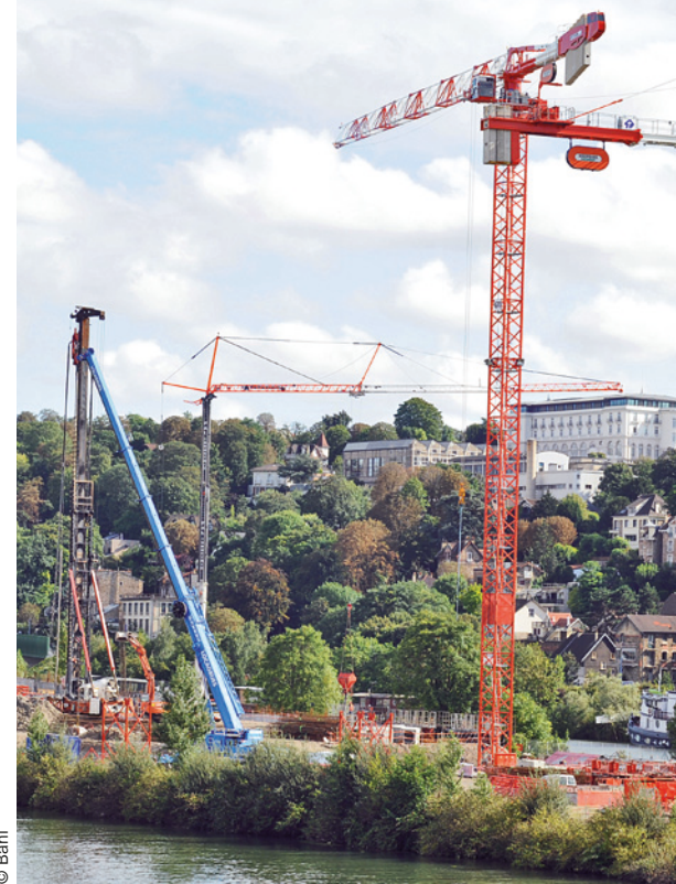
■ Commencés en janvier, les travaux de la Cité musicale avancent à grands pas.
