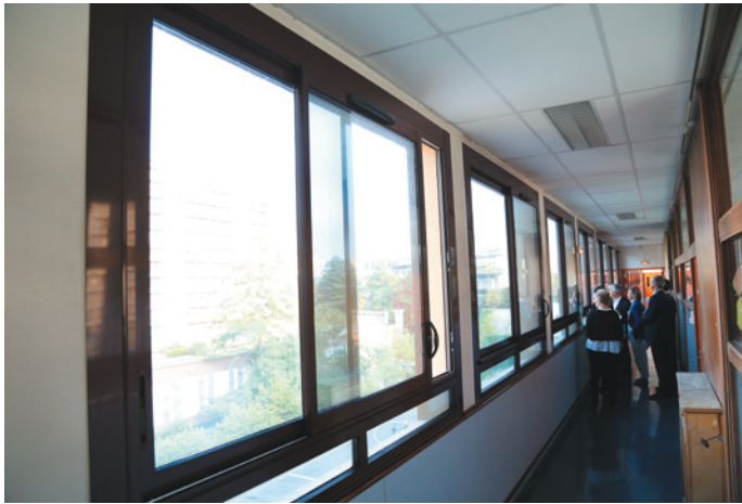
■ Les châssis des fenêtres et les rideaux de l'école Escudier ont été remplacés.
