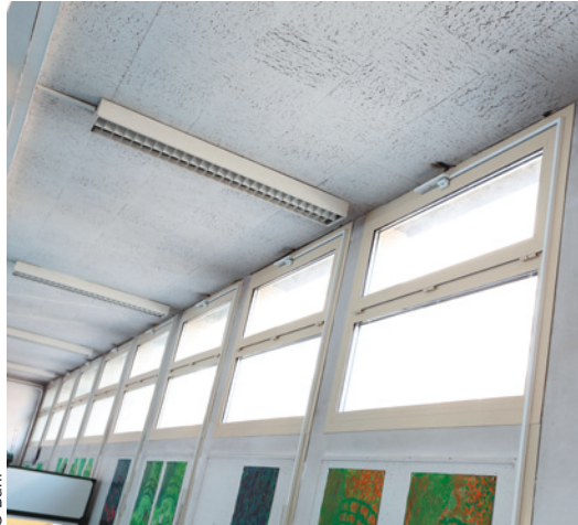
■ À l'école Lazare Hoche : remplacement des menuiseries et traitement des infiltrations du réfectoire.
